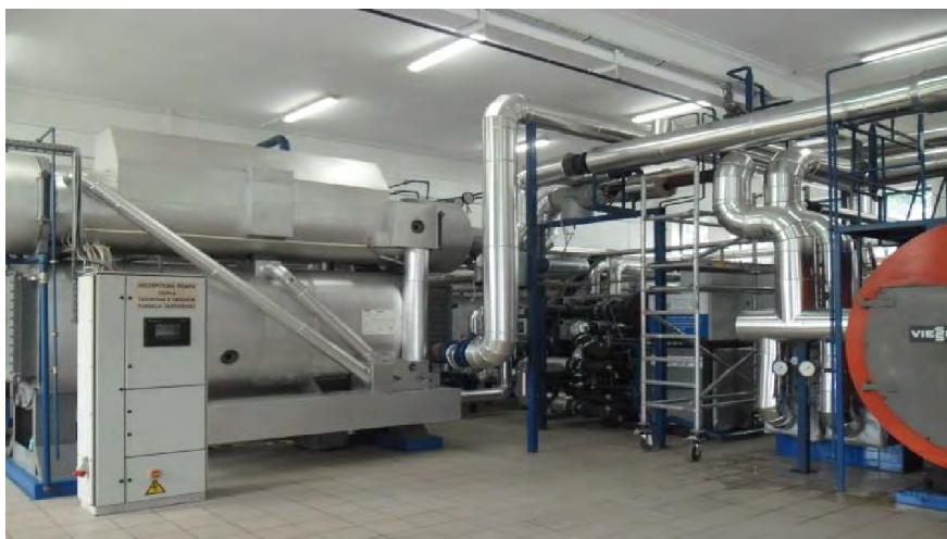
Ryc. 10.2.6. Wnętrze ciepłowni geotermalnej w Mszczonowie – absorpcyjna pompa ciepła (po lewej), sprężarkowa pompa ciepła (pośrodku w głębi), kocioł szczytowy (po prawej) (arch. Geotermii Mazowieckiej SA)
