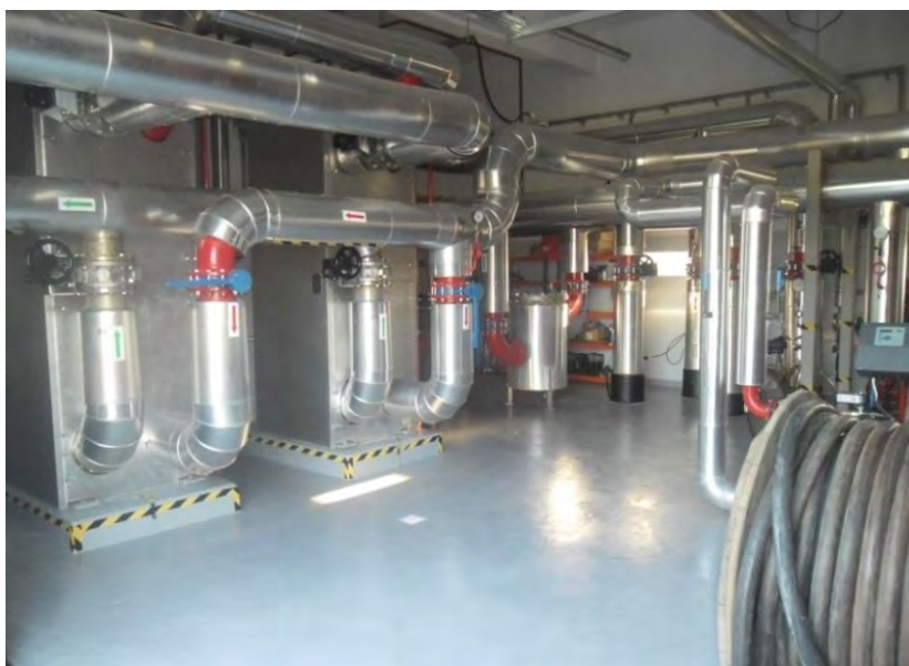
Ryc. 10.1.12. Wymienniki ciepła w instalacji geotermalnej w Poddębicach (arch. Geotermii Poddębice sp. z o.o.)
