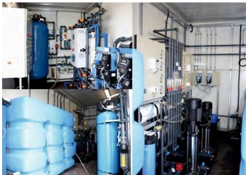
Ryc. 18.2.1. System odsalania wód geotermalnych w Laboratorium Geotermalnym IGSMiE PAN (fot. B. Tomaszewska)
