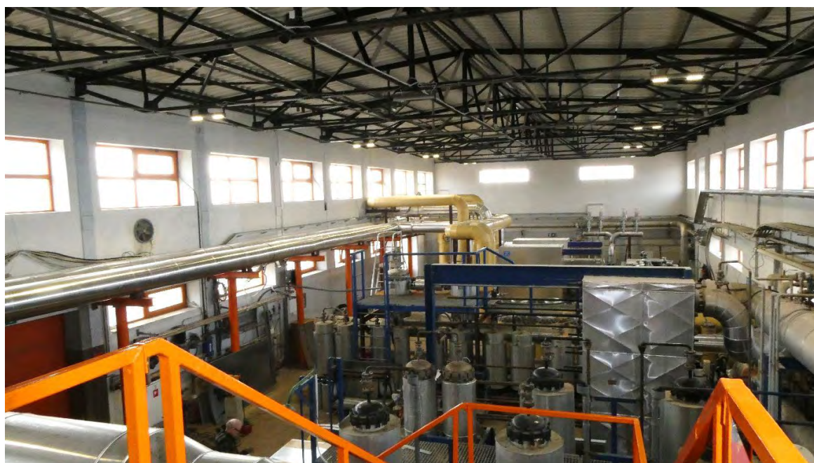
Ryc. 10.2.10. Ciepłownia geotermalna w Stargardzie – fragment instalacji (arch. GTerm Energy sp. z o.o.)
