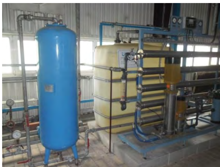
Ryc. 10.2.4. Ciepłowni geotermalna w Pyrzycach – fragment instalacji (arch. Geotermii Pyrzyce sp. z o.o.)
