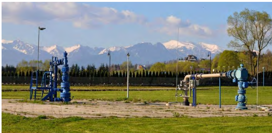
Ryc. 10.2.2. Głowice otworów produkcyjnych Bańska PGP-1 (po lewej) i Bańska PGP-3 (po prawej) – podstawowych elementów geotermalnego systemu ciepłowniczego na Podhalu (fot. arch. PEC Geotermia Podhalańska SA)
