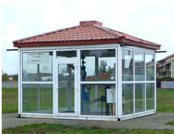
Ryc. 10.2.7. Głowica otworu produkcyjnego z którego wydobywana jest woda geotermalna dla potrzeb sieci ciepłowniczej i uzdrowiska w Uniejowie (arch. Geotermii Uniejów sp. z o.o.)
