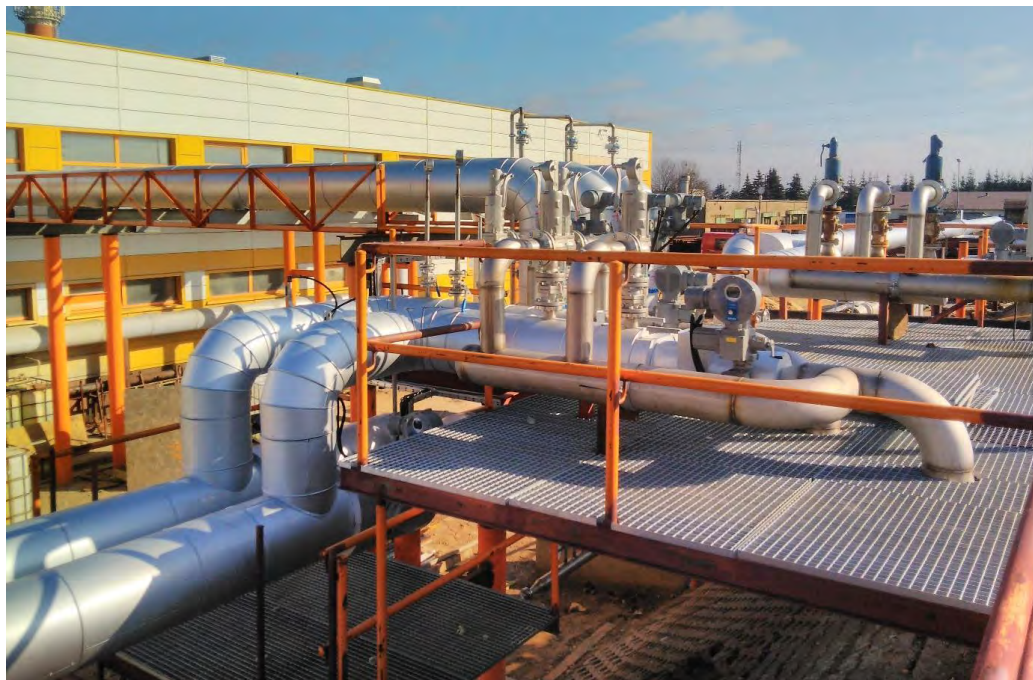
Ryc. 10.2.9. Ciepłownia geotermalna w Stargardzie – fragment instalacji (arch. GTerm Energy sp. z o.o.)
