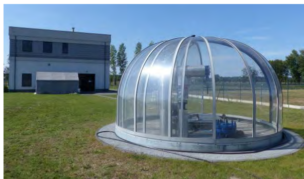
Ryc. 10.2.11. Głowica otworu geotermalnego, w tle budynek ciepłowni geotermalnej w Poddębicach (arch. Geotermii Poddębice sp. z o.o.)
