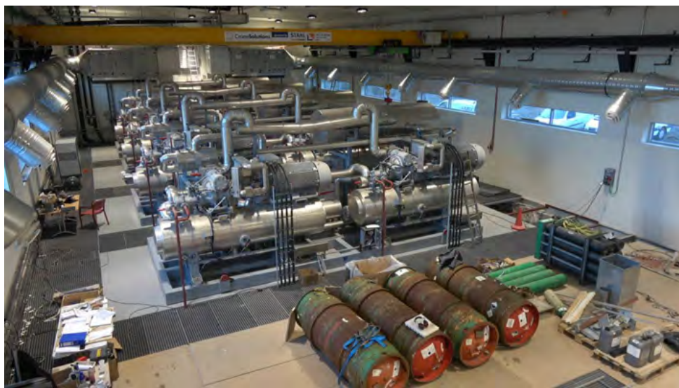
Ryc. 1.4.5. Wnętrze stacji z instalacją pompy ciepła w Vestmannaeyjar ( www.hsveitur.is )
