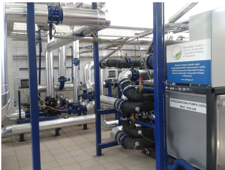
Rys. 40. Sprężarkowa pompa ciepła w Zakładzie Geotermalnym w Mszczonowie (fot. B. Bielec)
