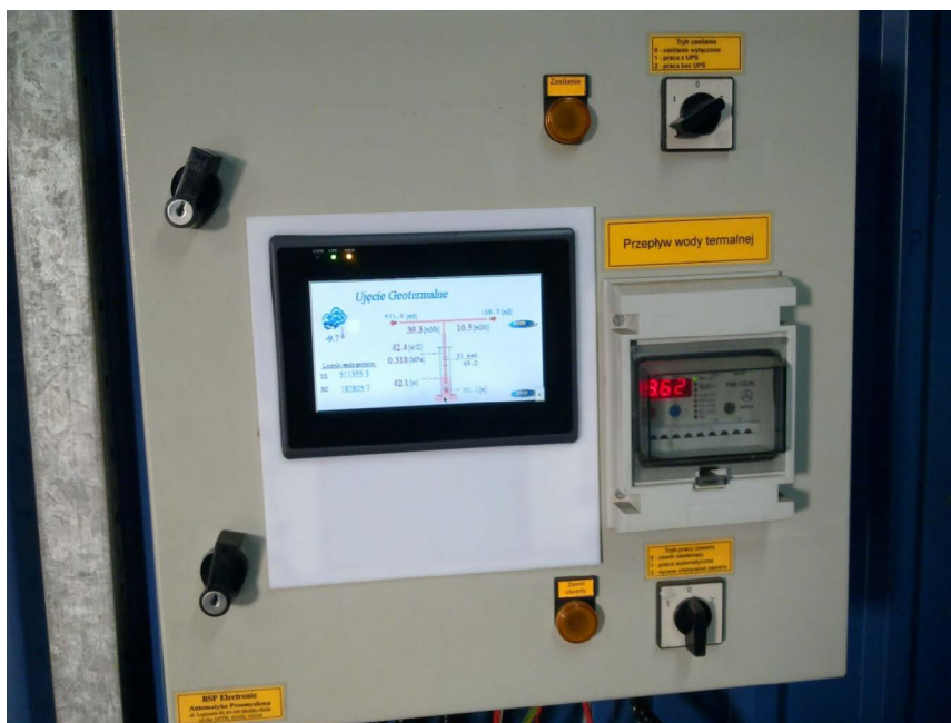
Rys. 36. Szafa sterownicza oraz widok panelu kontrolnego (fot. B. Bielec)
