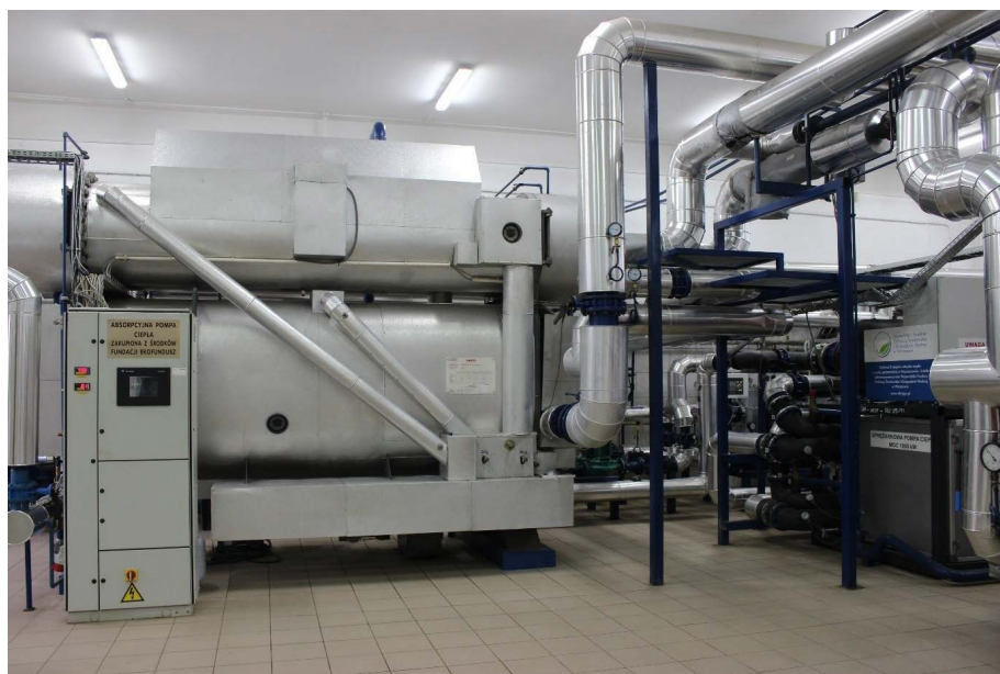
Rys. 38. Absorpcyjna pompa ciepła w Zakładzie Geotermalnym w Mszczonowie (fot. M. Słówek)
