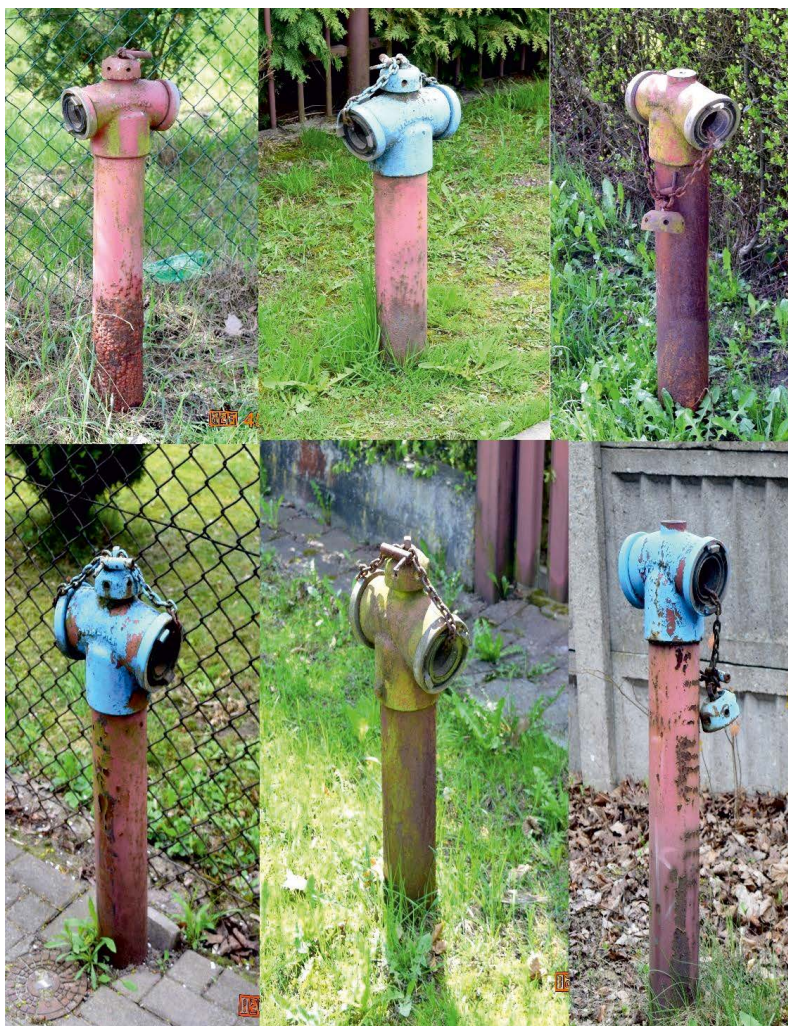
Rys. 2.20. Przejaw poszanowania podległych elementów infrastruktury (Foto S.O. 2016); trudny do zaakceptowania, ale możliwy do zrozumienia; wiejskie hydranty przeciwpożarowe. Głowice zabezpieczone przed nieuprawnionym pobieraniem wody; brak koniecznych zaślepek kłódki na łańcuchach skorodowane, a zawory zapewne uszkodzone; ujawnia się tu wyraźny rozryw między dobrymi intencjami i odpowiedzialnością, a spodziewanym funkcjonowaniem urządzeń w potrzebie
