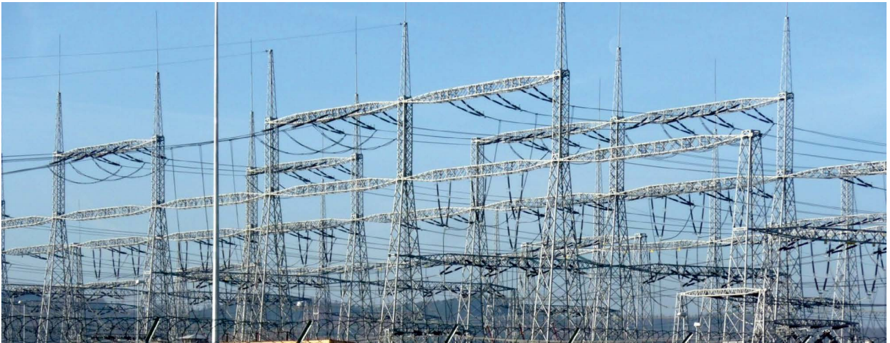
Rys.2.65. Urządzenia peryferyjne systemów energetycznych, wystawione na działanie zmiennych warunków atmosferycznych, ale ze względu na przejrzystość konstrukcji łatwe do utrzymania i serwisu (Foto S.O. 2014)
