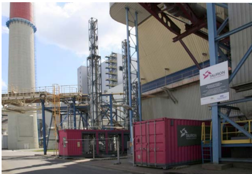
Rys. 1. Widok instalacji pilotowej w Elektrowni Jaworzno
