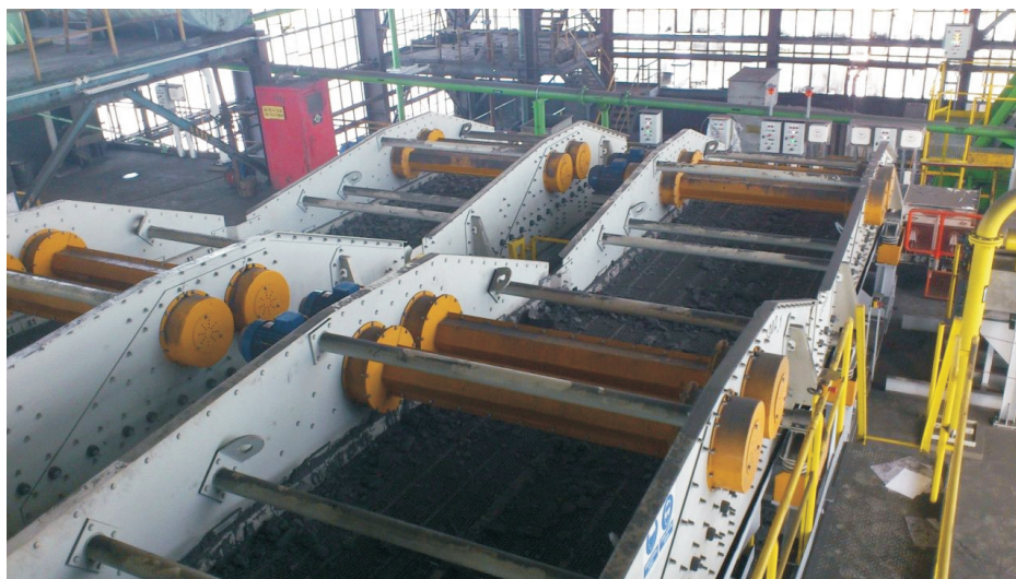
Rys. 4b. Dwa ciągi posobnie posadowionych przesiewaczy PWP1-2,2 × 5,25
