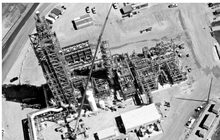
Rys. 3. Widok instalacji demonstracyjnej usuwania CO 2 o wydajności 500 ton/dobę, z zastosowaniem procesu KM-CDR Improved Process™
