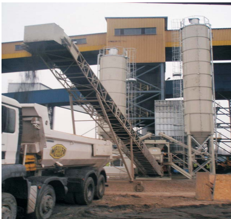
Fot. 10. Instalacja do produkcji mieszanek kruszywo-popiołowych funkcjonująca w ZG Sobieski
