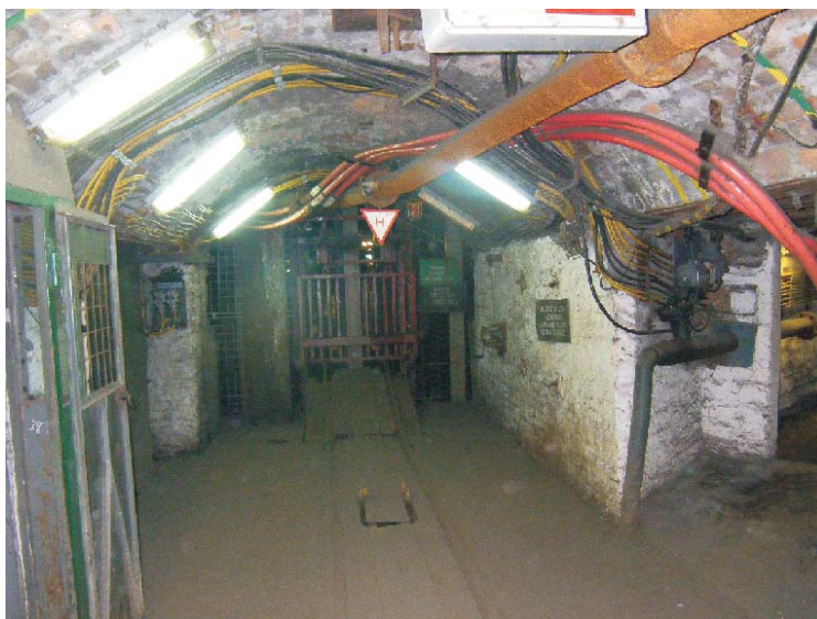
Fot. 11. Fragment rurociągu do podawania zawiesiny popiołowej w ZG Sobieski
