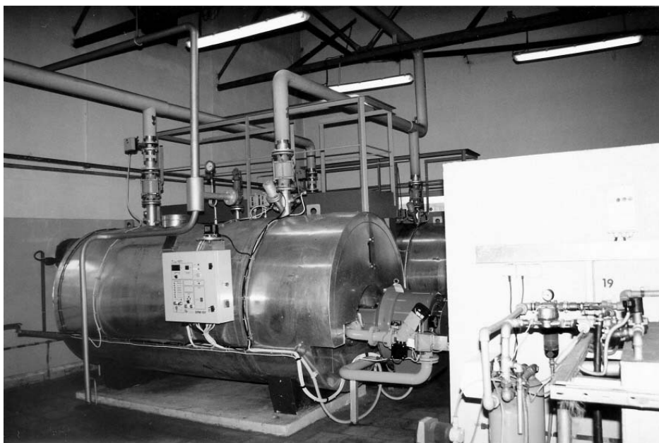
Rys. 1. Kotły gazowe oraz stacja uzdatniania wody kotłowej
