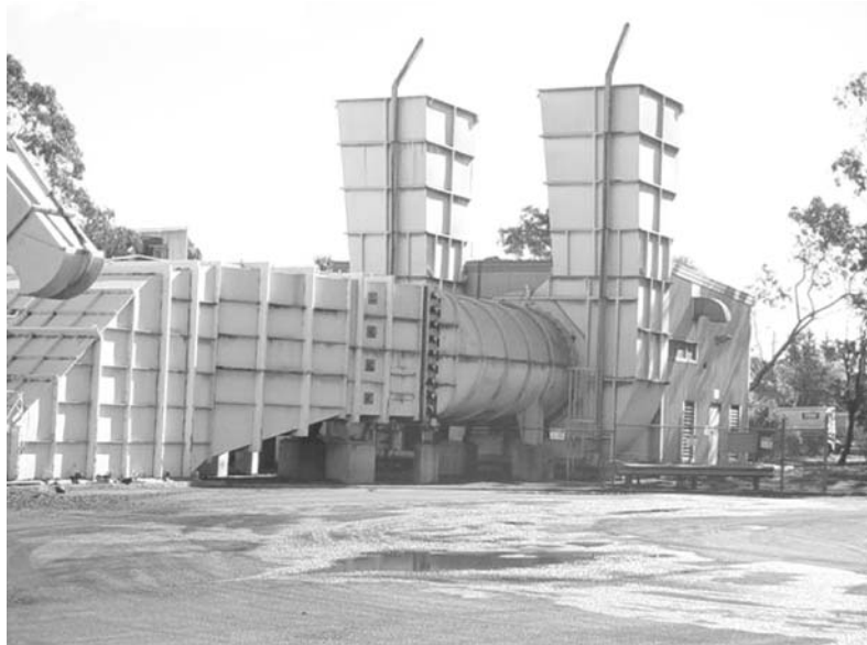
Rys. 6. Szyby wentylacyjne kopalni West Cliff przed podłączeniem Vocsidizera
