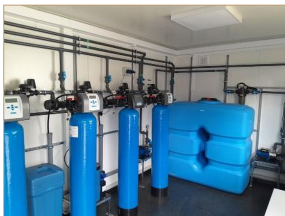
Stacja badawcza do uzdatniania wody geotermalnej z hybrydowym systemem odsalania wraz z instalacją termicznego zatężania koncentratu
