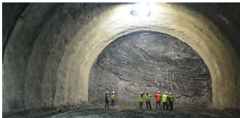
Analiza spękań fliszu karpackiego w przodku tunelu pod masywem Lubonia Małego na Zakopiance (fot. Z. Pilecki)
