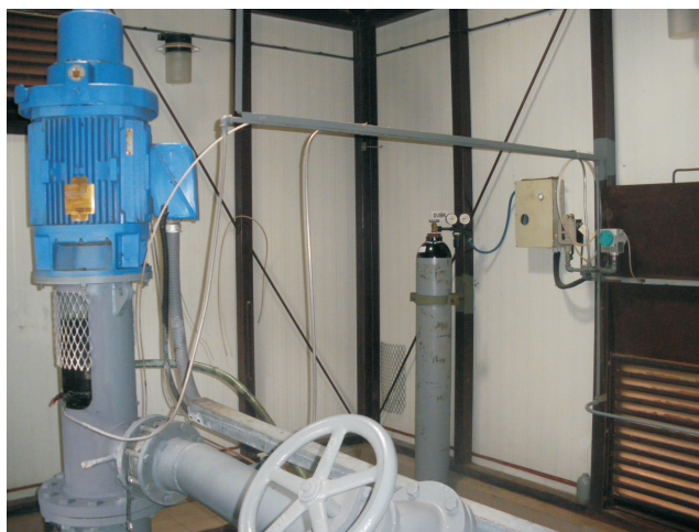
Rys. 2. Galanta (Słowacja): głowica otworu wydobywającego wodę geotermalną dla potrzeb sieci c.o. w dzielnicy miasta objętej pracami Projektu GEOCOM (w głębi widoczna jest m.in. butla z azotem, który służy do inertyzacji instalacji geotermalnej, co zapobiega rozwojowi korozji podczas przerw w jej pracy) (fot. B. Kępińska)
