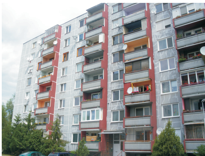
Rys. 1. Galanta (Słowacja): blok mieszkalny z wielkiej płyty w trakcie prac termomodernizacyjnych Projektu GEOCOM (widoczne wypełnione już pęknięcia i szczeliny). Wykonanie tych prac przyniosło spadek zużycia ciepła o ok. 30%, co jest równoznaczne z obniżeniem rachunków za ciepło i możliwością zasilenia nowych obiektów z istniejącej sieci geotermalnej (fot. B. Kępińska)
