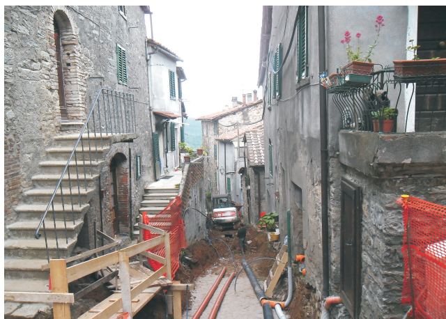
Rys. 4. Montieri (Włochy): układanie rur dystrybucyjnych geotermalnej sieci c.o. i wykonywanie połączeń do obiektów w warunkach historycznej zabudowy miasta, wąskich ulic i zamieszkałych budynków. Prace inwestycyjne Projektu GEOCOM (fot. B. Kępińska)
